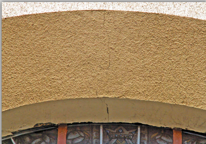
Pęknięte nadproże okienne
