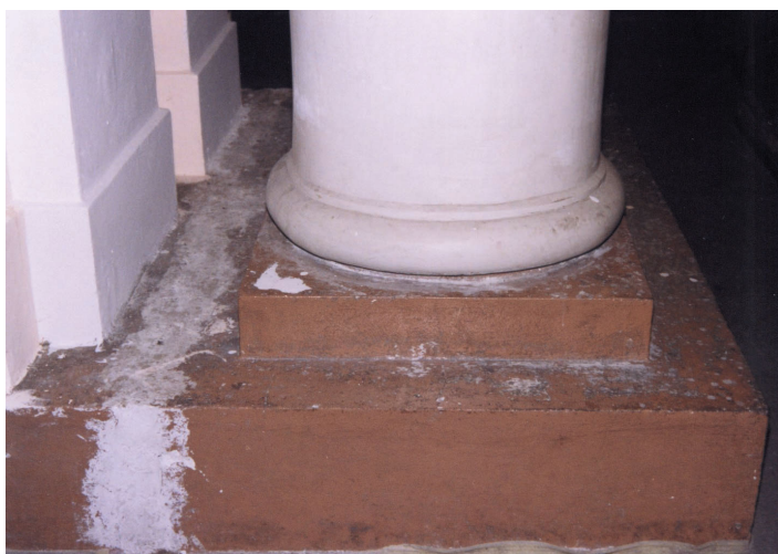
Cokoły filarów przed remontem.
