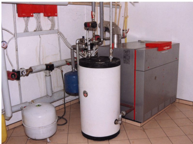
Piec centralnego ogrzewania zainstalowany w piwnicy plebanii.
