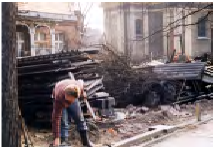
Widok terenu przed plebanią od strony ul. Wyzwolenia. Wykonywanie fundamentu pod ogrodzenie.
